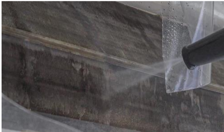
5. 開始高壓水槍沖洗 (清洗熱交換器、風扇滾筒、水盤、通去水位)
